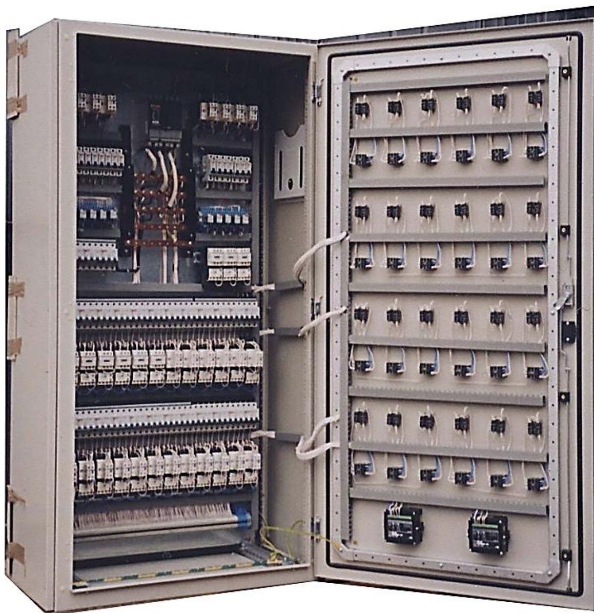
Рисунок 14 – Шкаф управления рукавным фильтром
